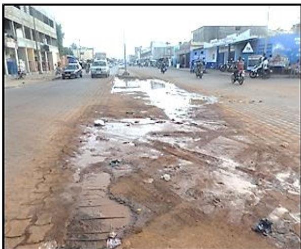
Photo n°3 : Stagnation d'eau pluviale
