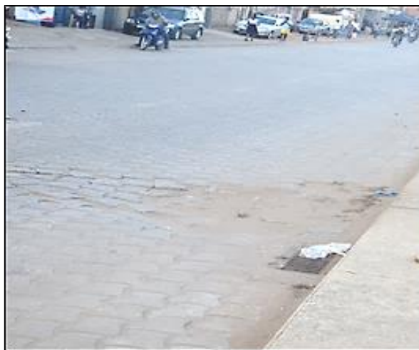
Photo n°4 : Nids de poule sur la voirie
