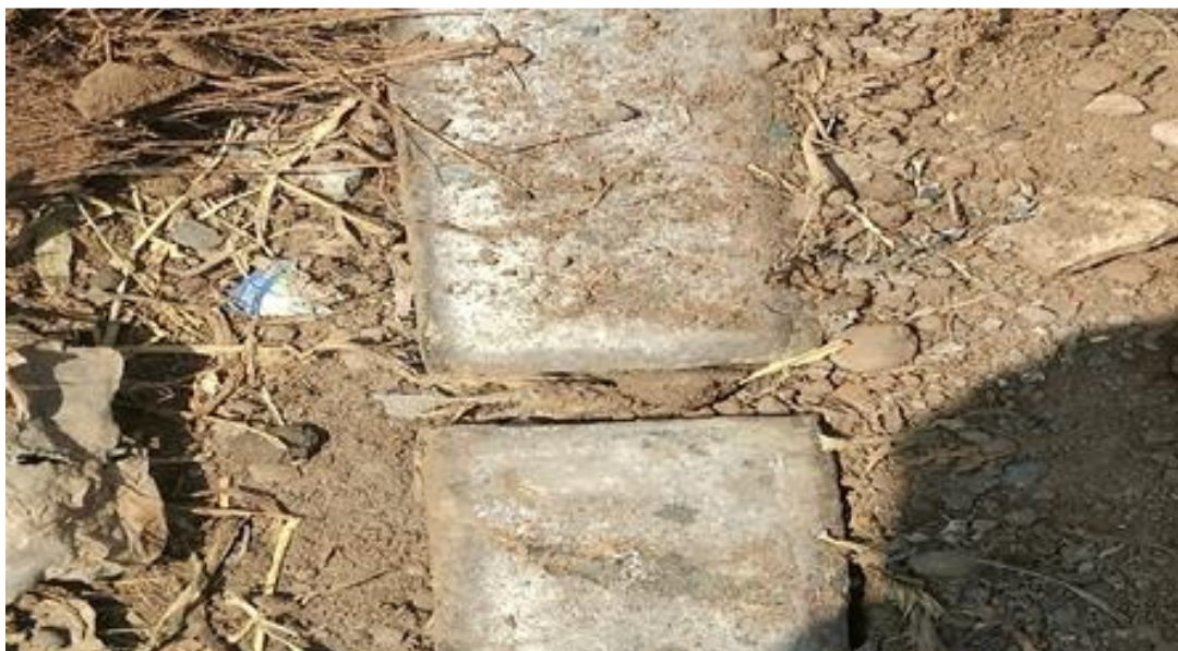
Photo 4 : Défaut de soudure de rails
