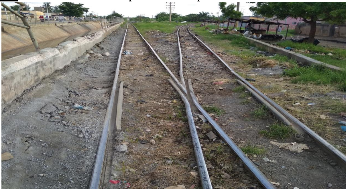
Photo 8 : Des voies non stabilisées par du ballast en pierre.
