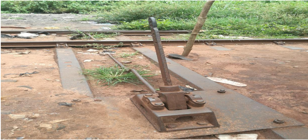
Photo 6: Levier de manœuvre à double action sur une section abandonnée à Tsévié.
